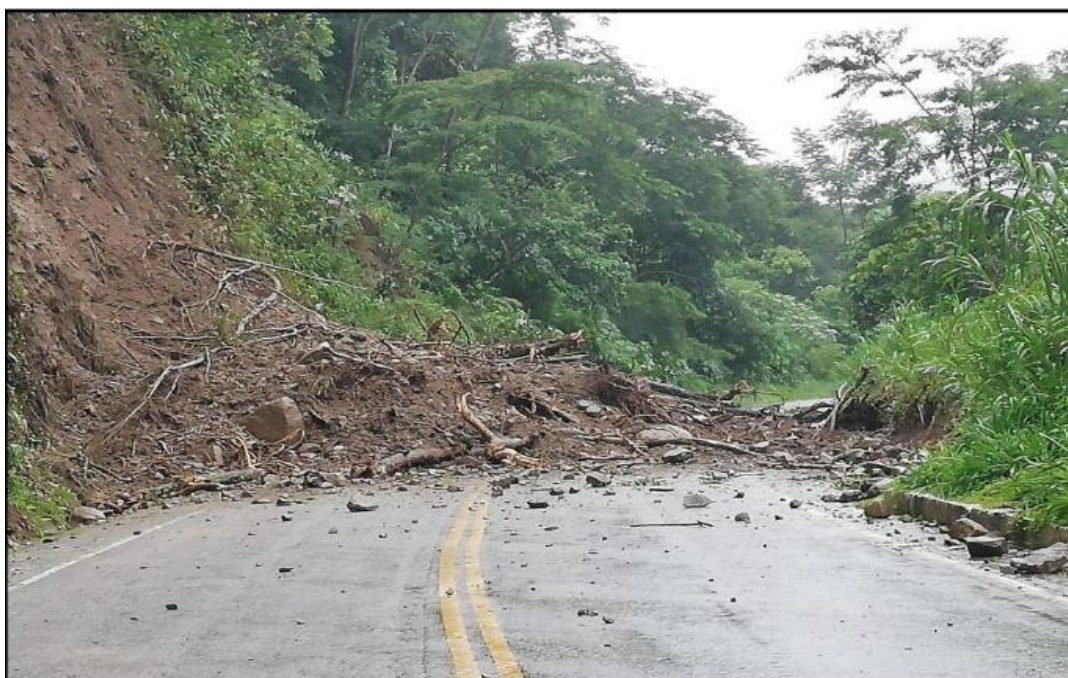
Figura 13. Derrumbe en la carretera de San Luis de Shuaro
