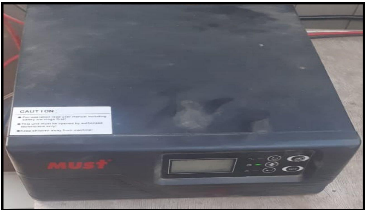
Convertidor de un Sistema Fotovoltaico
