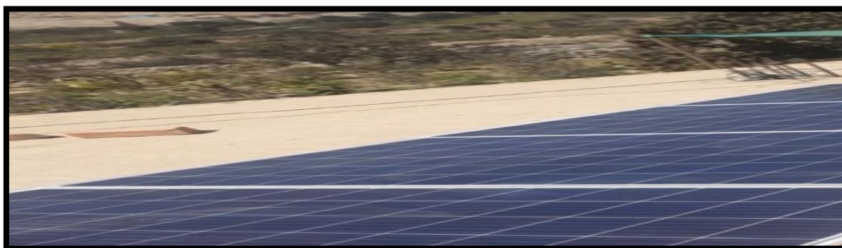
Placa fotovoltaica de un Sistema de Energía Solar
