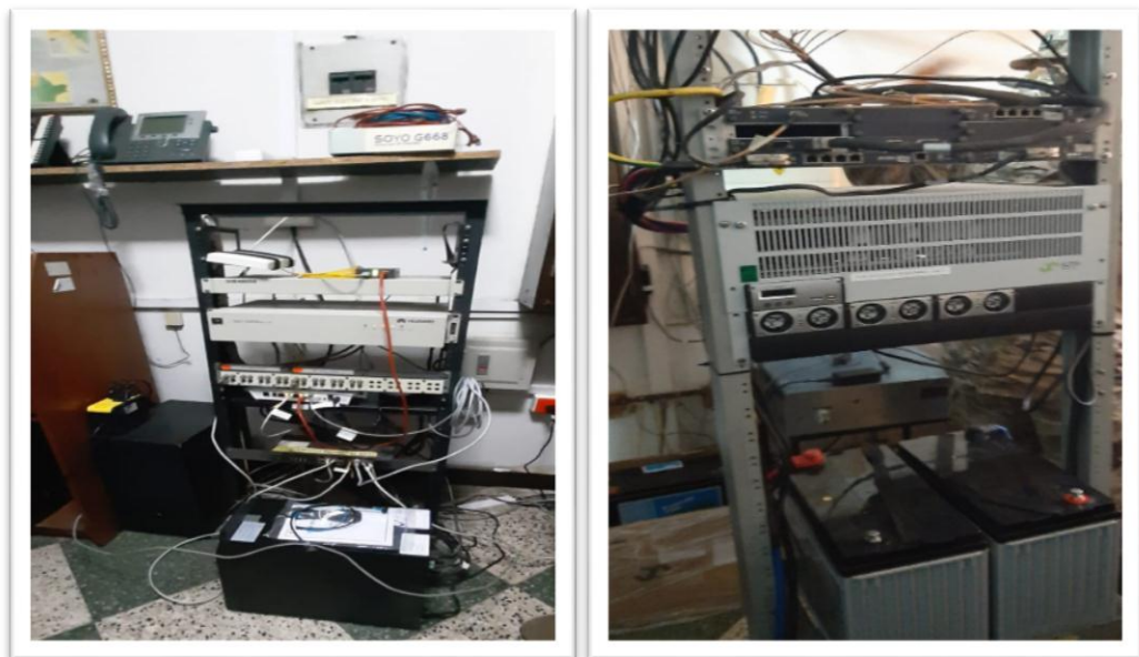
Figura 15. Banco de baterías
