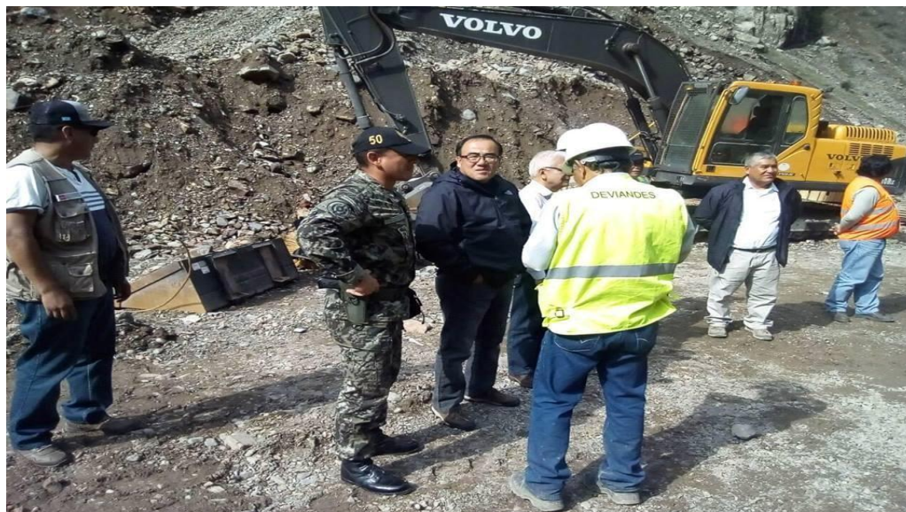
Figura 1. Visita del Ministro de Transportes y comunicaciones en los trabajos de limpieza de la carretera Central, marzo 2016
